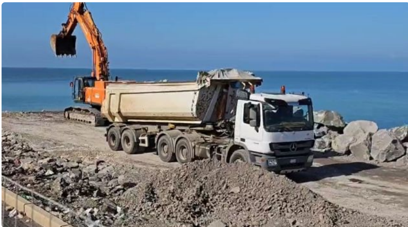
Le ruspe al lavoro per la realizzazione della darsena per i pescherecci
